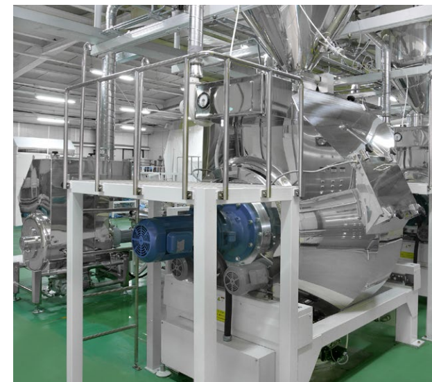
6.レシーバー及びミキサー設備
