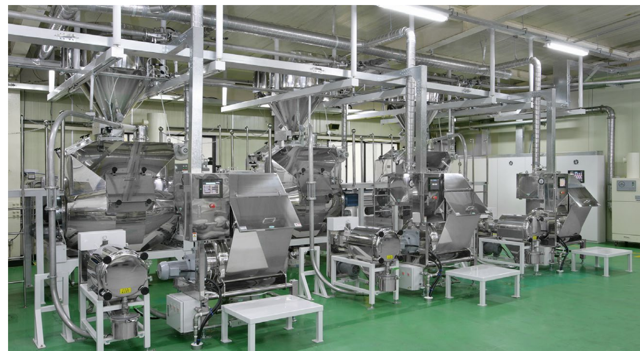
4.副原料切込み及びミキサー設備
