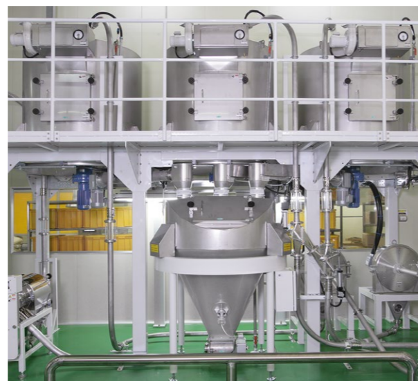
3.粉碎・貯槽・計量及びふるい設備
