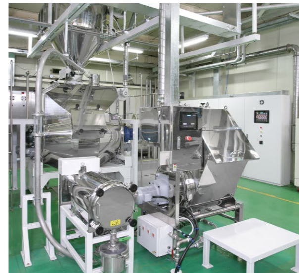
5.副原料切込み及び輸送設備
