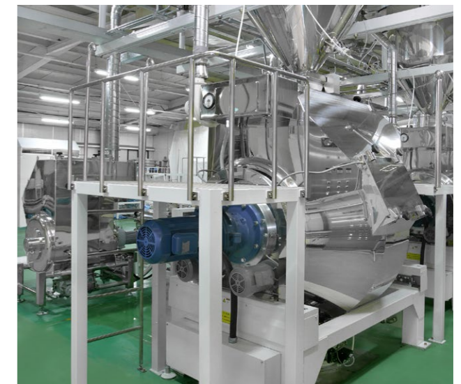
6.レシーバー及びミキサー設備
